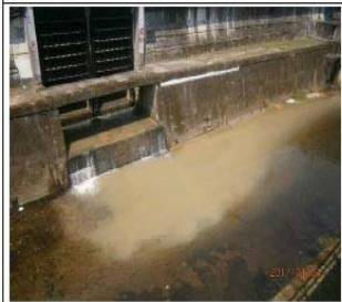
5. 106/4/5 工區放出口1水質混濁影響四分儀。
