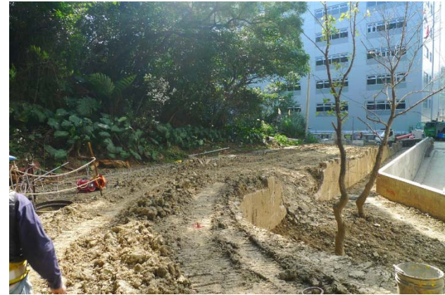
(2) 工程施工樹木再次移植，與原移植樹木配置圖不符
